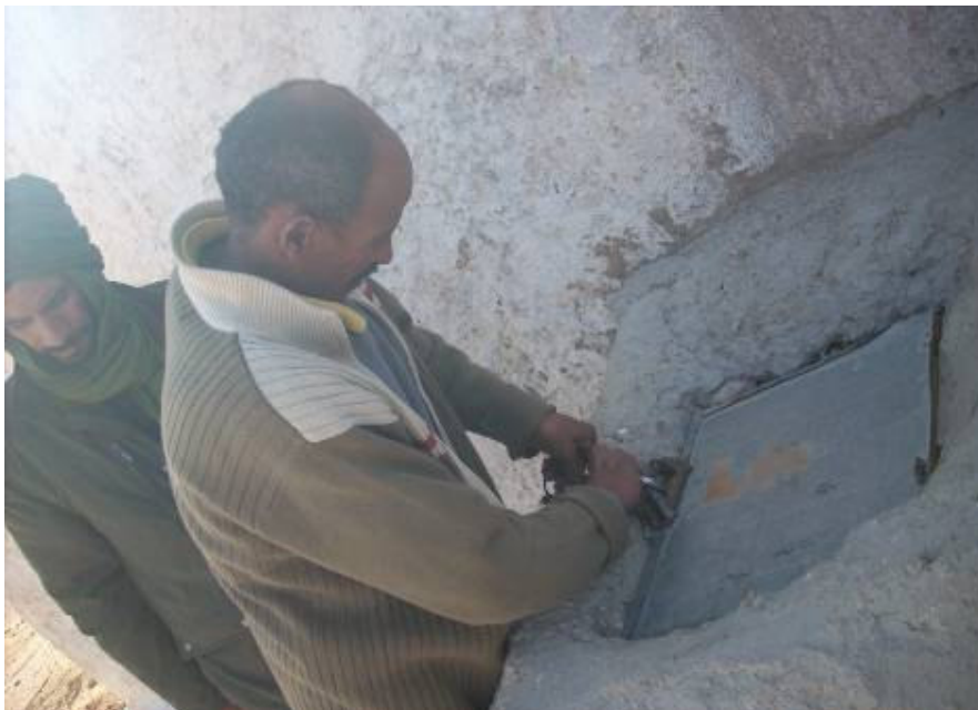
Fig. 6: Presa d'acqua intercettata sul collettore del nuovo serbatoio.
