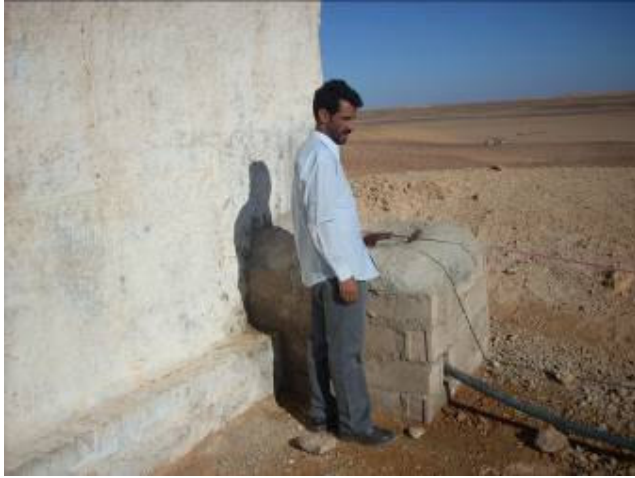
Fig. 11: Misurazione della linea dal serbatoio.
