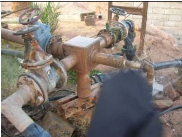
Preso d'acqua attuale dell'acquedotto
