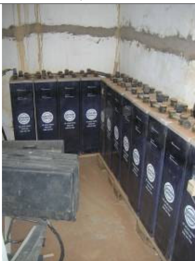
Sistema di accumulatori
